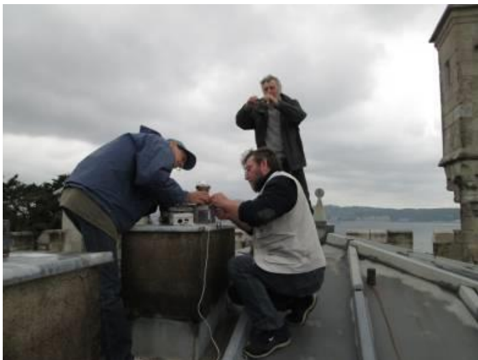
Fig. 33 - Installation de la caméra « FRIPON » sur le toit du château d'Abbadia en 2015 (debout : Jean-Eudes Arlot).
